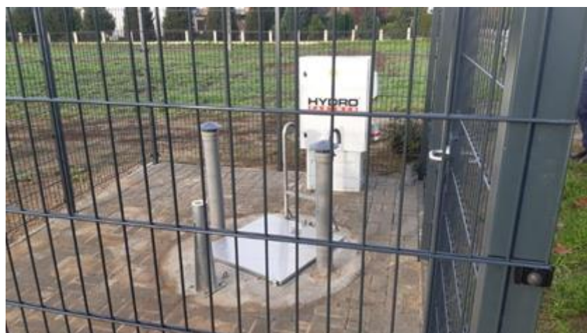
Zdjęcie nr 19 Przepompownia ścieków Lubiszyn ul. Leśna
