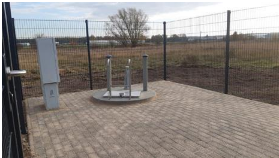
Zdjęcie nr 20 Przepompownia ścieków Lubiszyn ul. Dworcowa
