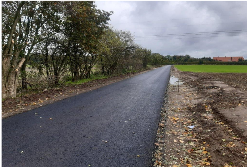
Zdjęcie nr 14 Droga gminna nr 002836F w Wysokiej
