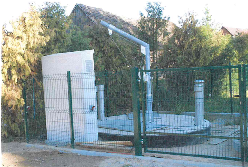
Sanitex Sp. z o.o. – Budowa kanalizacji ściekowej wraz z przepompowniami oraz odcinkami przyłączy w m. Wysoka
